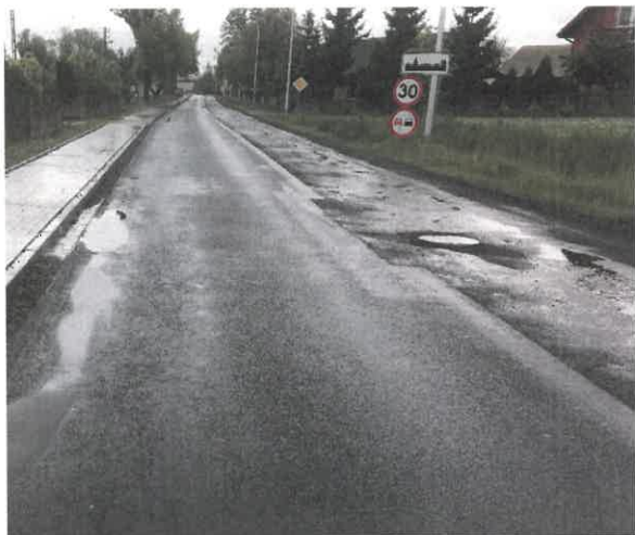
Zdjęcie 1 Widok ogólny stanu nawierzchni po wykonanych zabiegach naprawczych – wjazd do miejscowości Złotków
