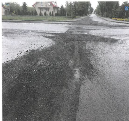
Zdjęcie 4 Widok ogólny stanu nawierzchni po wykonanych zabiegach naprawczych – skrzyżowanie z drogą gminną w miejscowości Złotków
